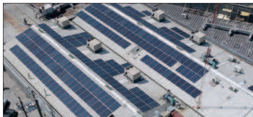
Instalación de autoconsumo de un centro de Walmart en Chile
